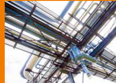
Rohrleitungen Fotograf: Michael Irmischer
