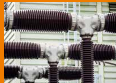
Umspannwerk Fotograf: Jürgen Neumann
